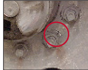
Fissure sur trous de goujon
